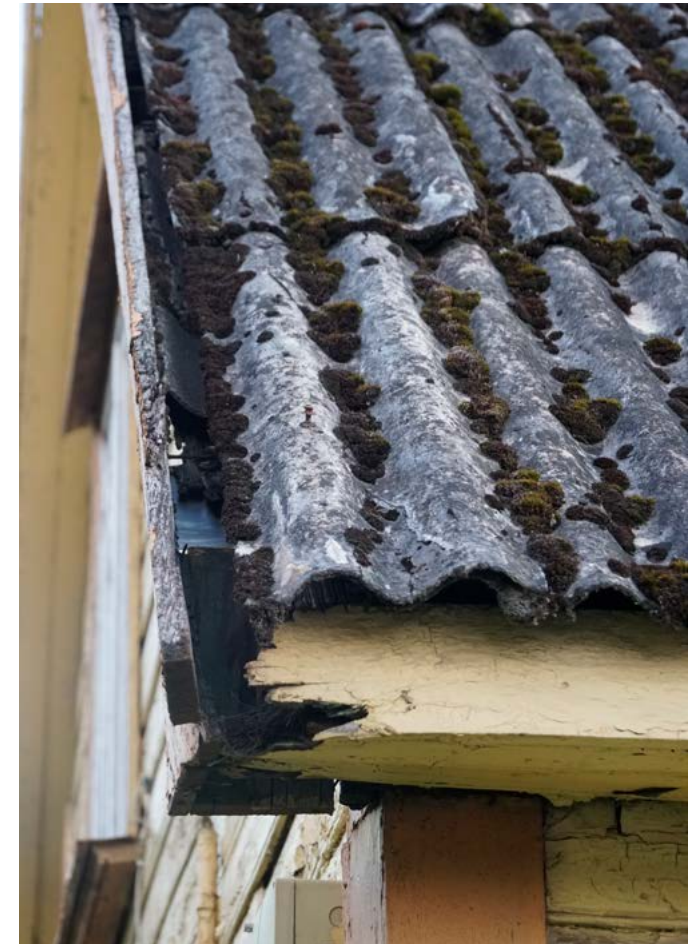
Puuduv viiluserva kattelaud on põhjustanud viilu äärelaua ja tuulekasti mädanikku. Riia mnt 187, Pärnu. Foto: Ü. Alev
