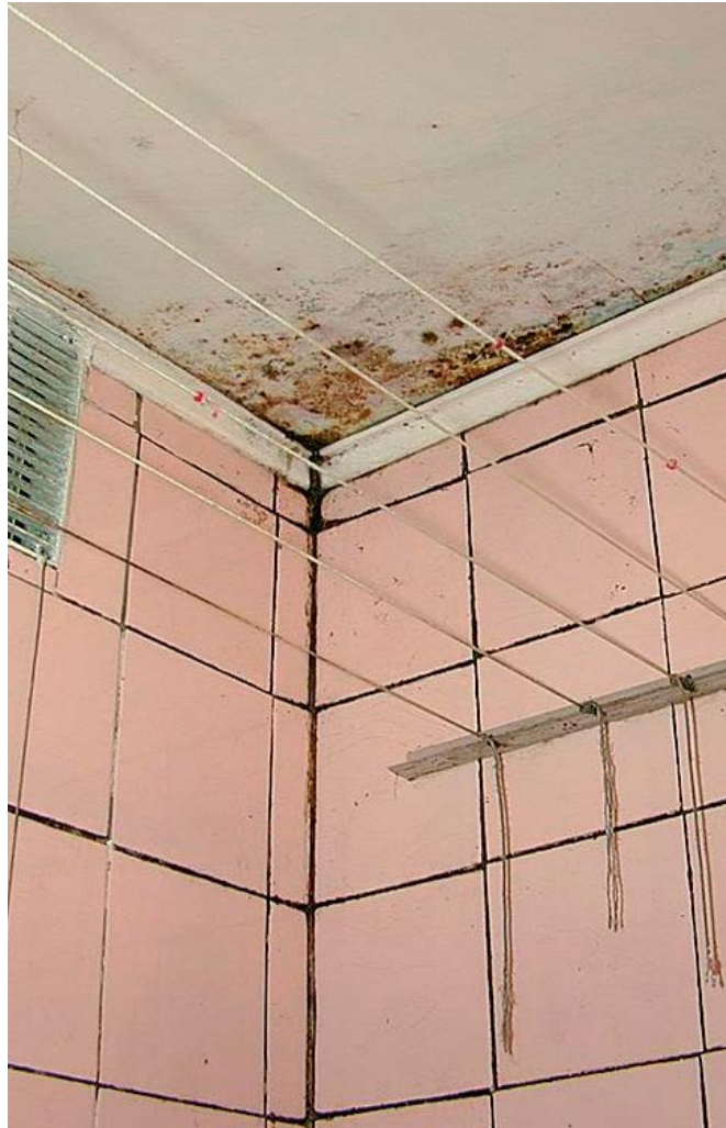
Puuduvast ventilatsioonist põhjustatud hallituskahjustus vannitoas.
