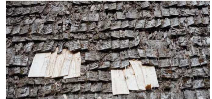
Kahjustunud laastukatus, näha ka paar uute laastudega paigutatud kohta. Foto: Ü. Alev
