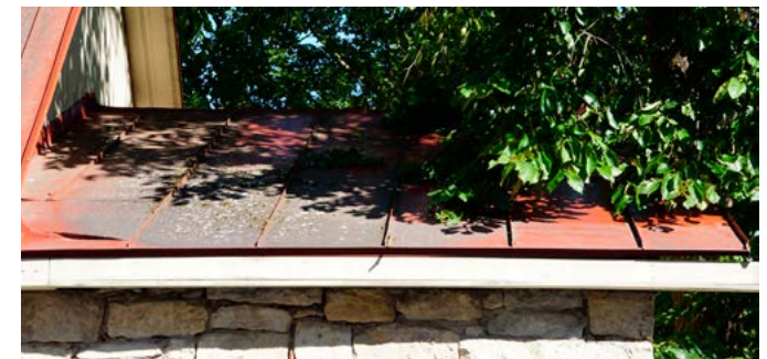
Katusele ulatuvad oksad võivad kahjustada värvkatet ja põhjustada katuse sammaldumist. Foto: Ü. Alev
