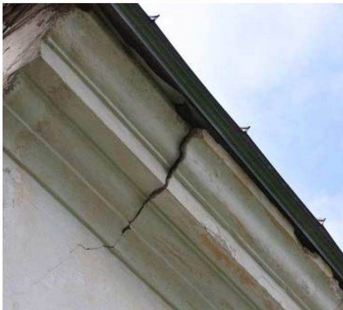
Karniisi väljavajumise on põhjustanud sarika räästatõstja vajumine karniisile. Foto: J. Vali
