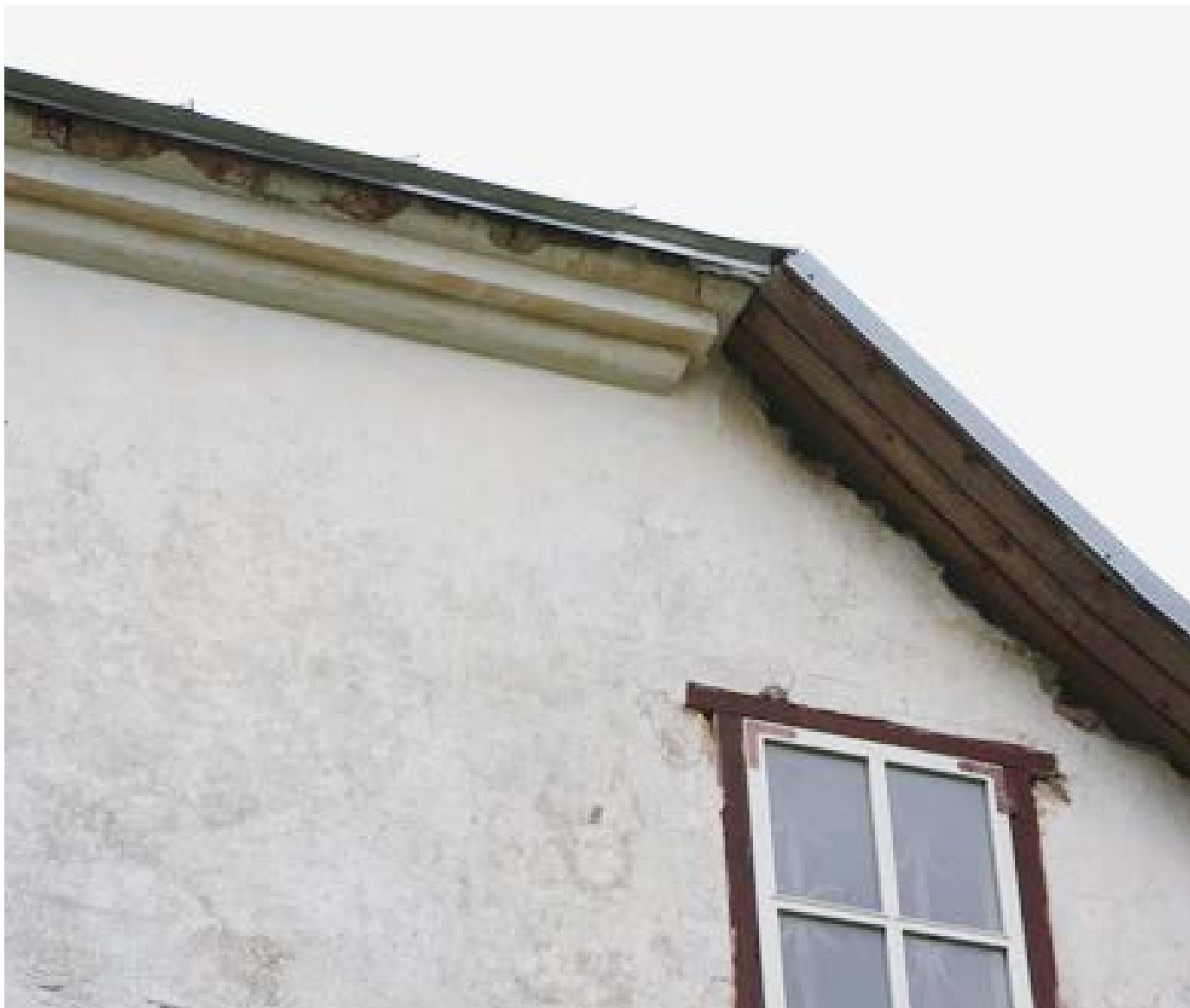
Katuse karniisita viiluäär, millest katuseserv on liiga kaugemale üle kasvatatud. Foto: J. Vali
