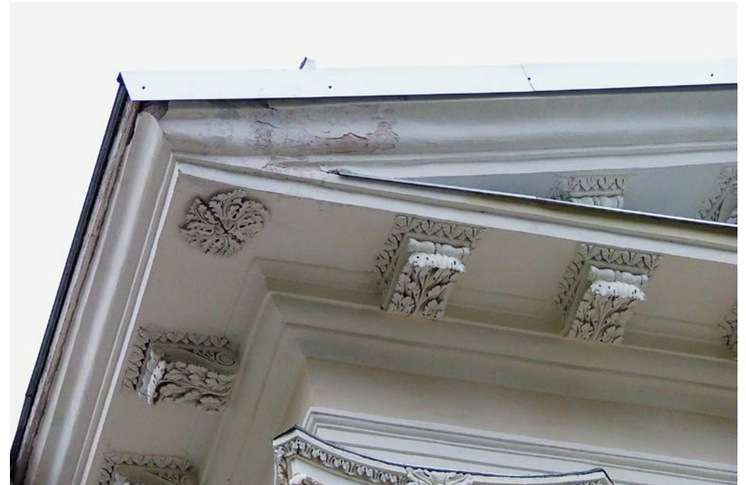
Klassitsistliku portikuse karniis. Pleki lõpetus on katuseserval remondi tulemusel alla pööratud ja varjab karniisi ülaserva. Foto: J. Vali
