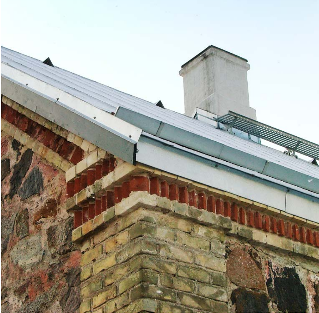
Katusepinna tõstmisega on telliskarniisi ja kattepleki vahele tekkinud lai pilu, mida on püütud ebaõnnestunult varjata alla pööratud plekiservadega. Hoone ja karniiside arhitektuurne ilme on rikutud. Foto: J. Vali
