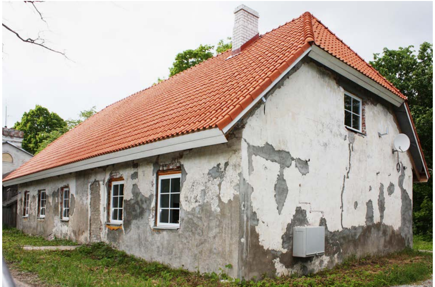
Projektita ehitades ja katusepinda tõstes jäävad karniisid ajaloolisele hoonele sobiva lahenduseta. Foto: J. Vali
