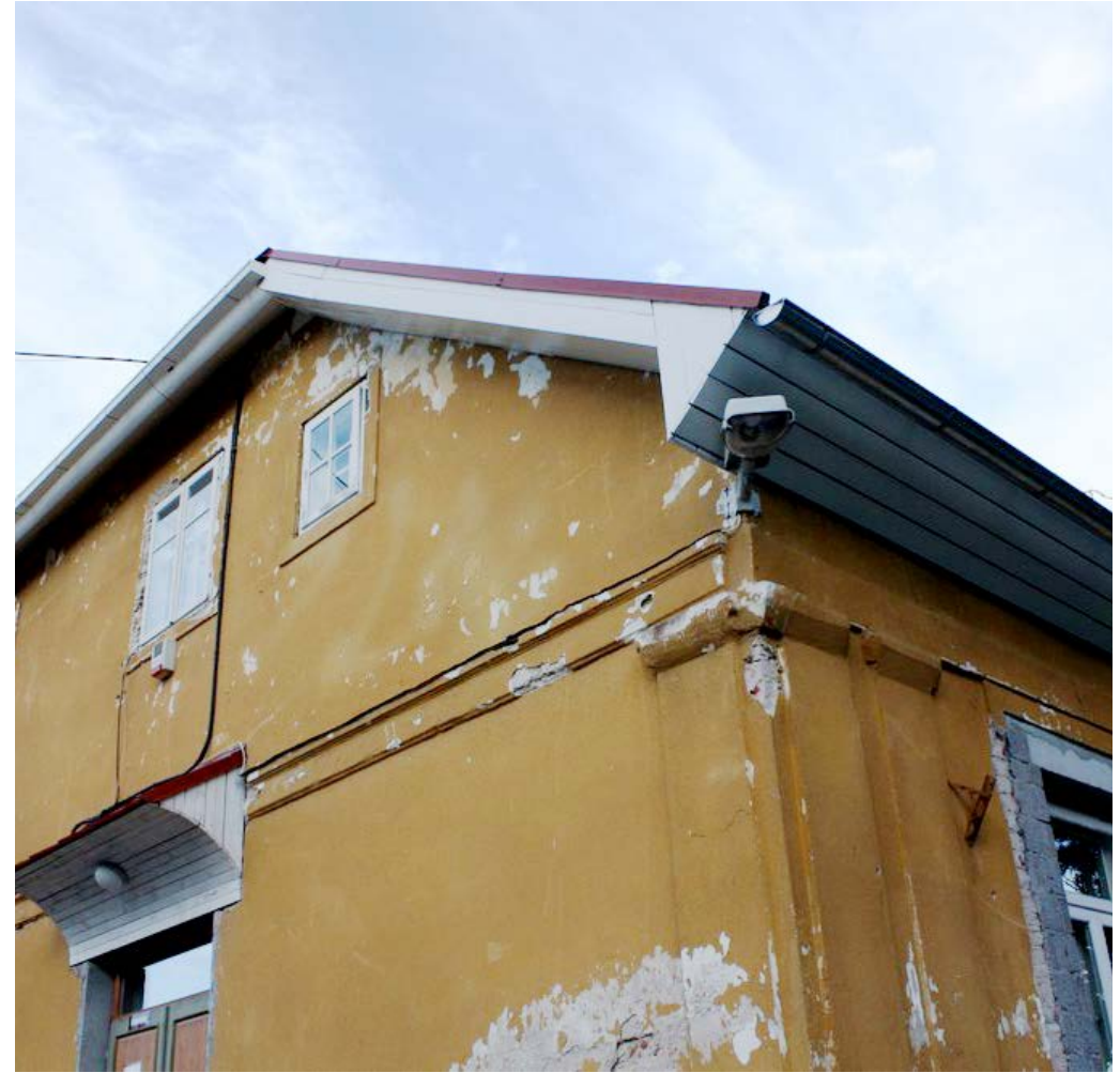
Katuse remondi käigus oskamatult kujundatud ja lõpetatud räästakarniis viiluseinal. Foto: J. Vali
