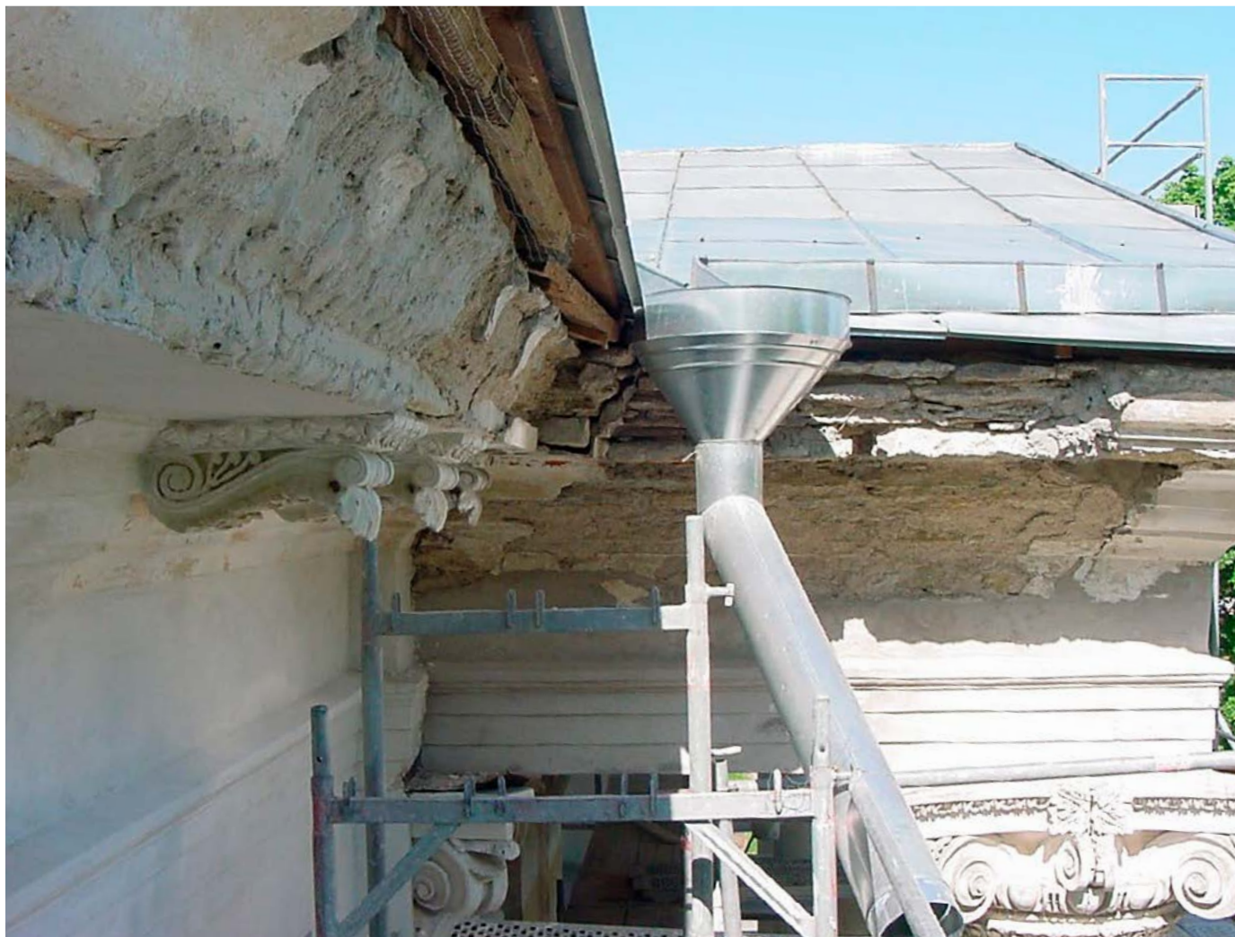
Katusekarniisi remontimine peale katuse remonti ei pruugi õnnestuda. Foto: J. Vali
