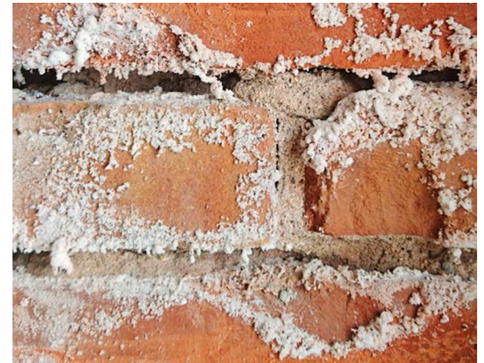
Soolakahjustused tellisel. Foto: M. Mändel
