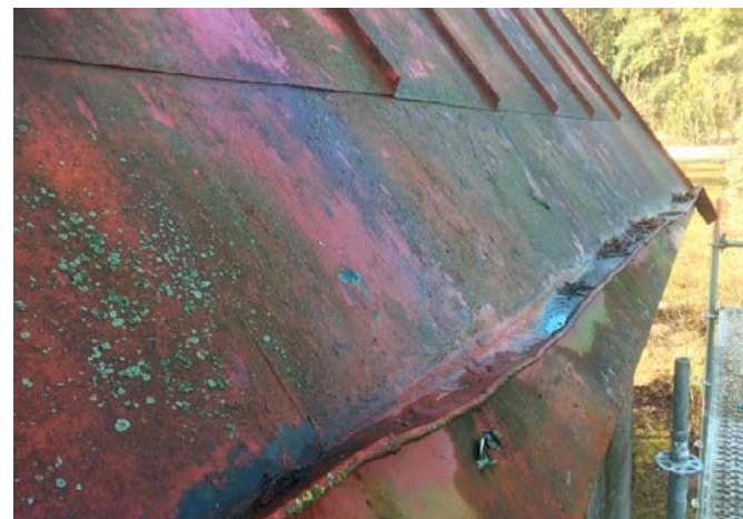
Haakidega toestatud katuserenn on lumekoormusele alla vandunud ja toehaagid on murdunud. Foto: K. Kondio
