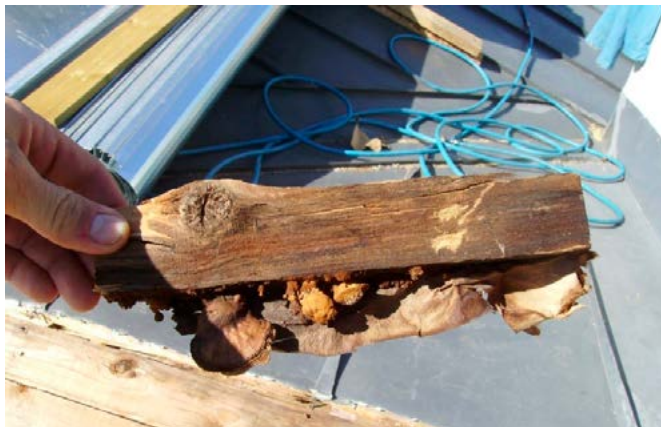
Katusealuse tuulutusvahe puudumise tõttu on jäänud niiskus pleki alla vangi ja põhjustanud seenkahjustuse. Foto: K. Kondio
